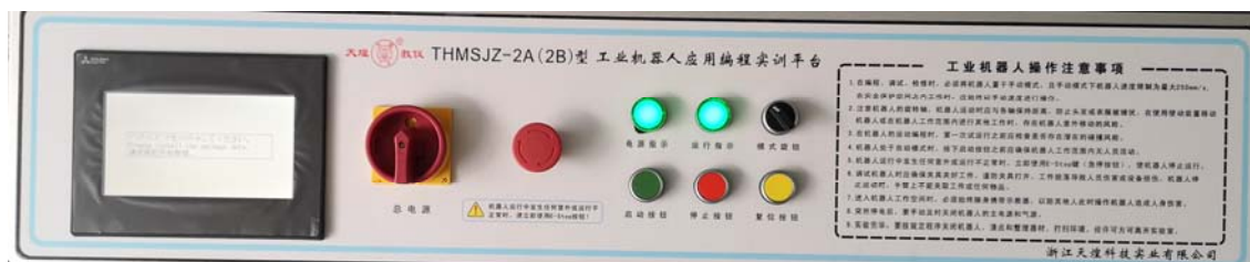
图2 平台电气控制面板1
