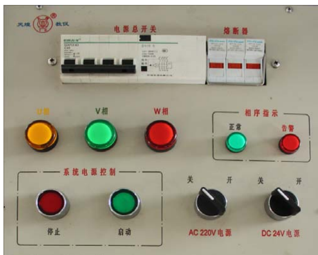
图1 平台电气控制面板1（局部）
