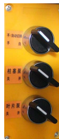
图3 泵站控制电控盒
