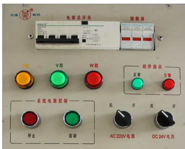
图1 平台电气控制面板1（局部）
