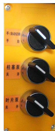
图3 泵站控制电控盒
