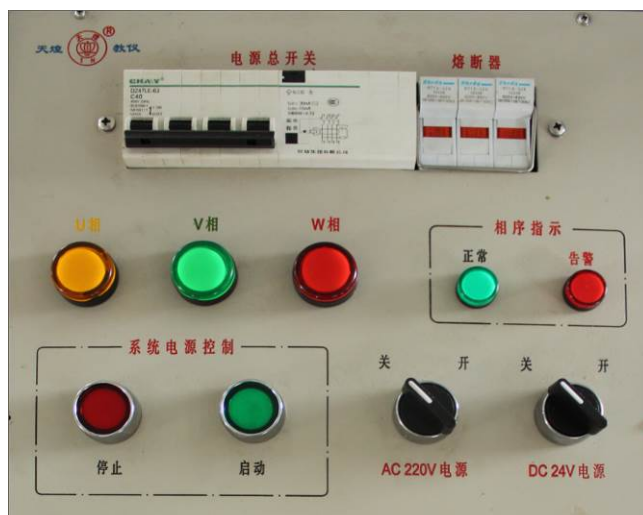
图1 平台电气控制面板1（局部）
