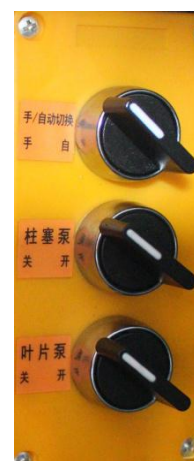
图3 泵站控制电控盒
