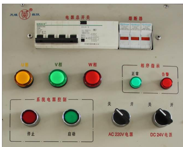
图1 平台电气控制面板1（局部）
