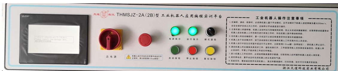
图2 平台电气控制面板1
